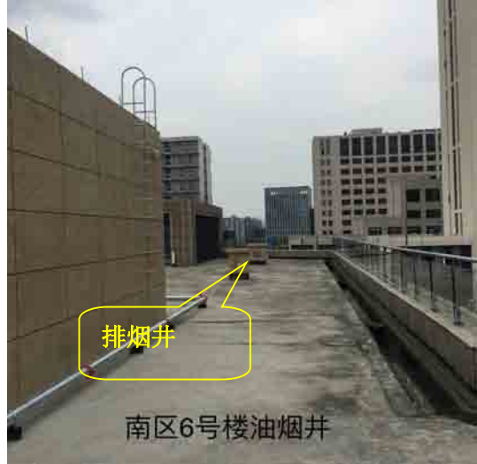
厨房油烟排烟井
