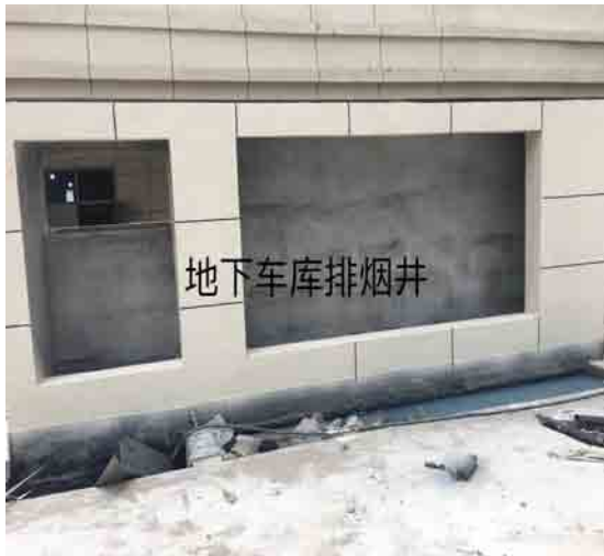
地下车库排烟井
