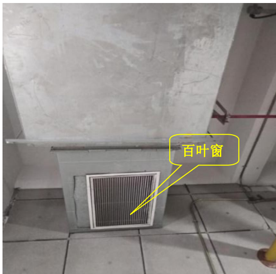
锅炉废气排放口
