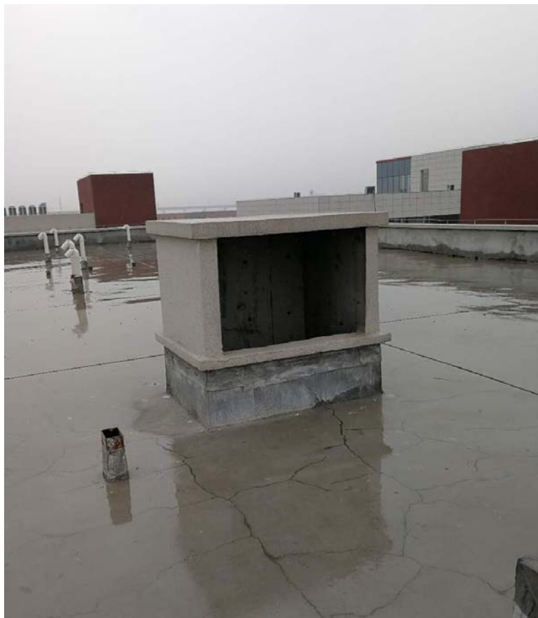
专用油烟排放竖井
