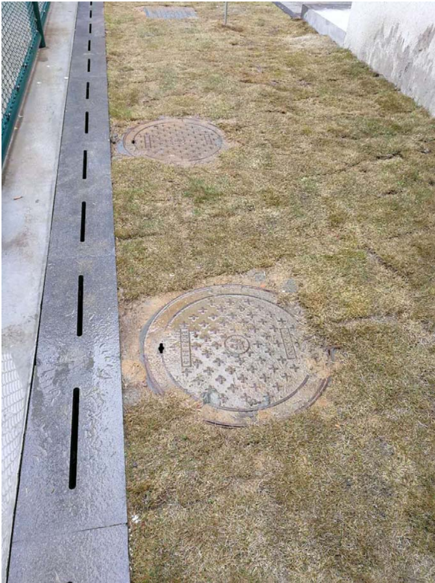
厂区内设置隔油池位置
